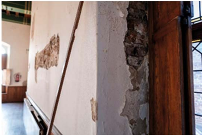
Rolzaal: vochtproblematiek bij kozijnen
