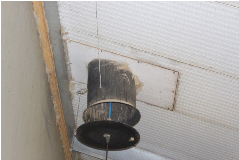
Figuur 2.18 Ventilatieschacht in het dak (Bron: Brandweeracademie)
